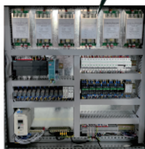
镇流器柜体内部
